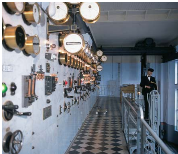
Marmor och mässing är slående inslag på manöverpanelen i Finnforsens gamla kraftstation. Foto Curt Dahlgren
